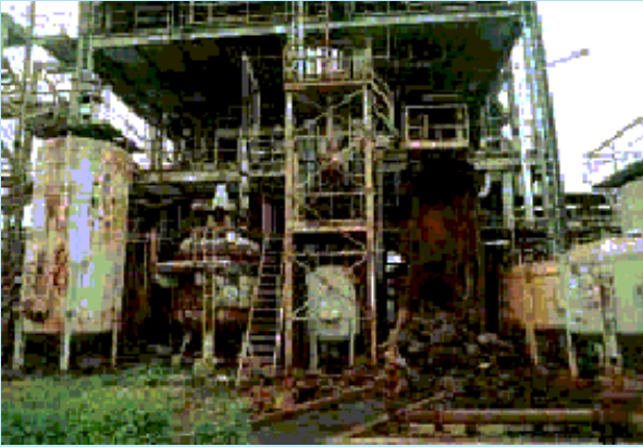
VISTA INTERIOR DE LA PLANTA
